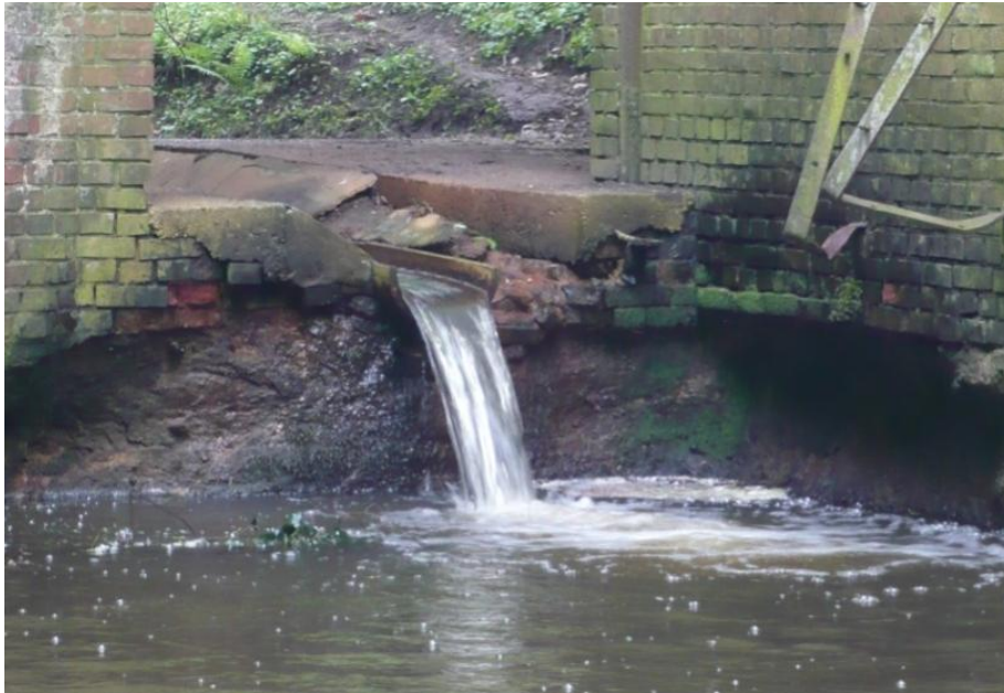
Abb. 2: Starke Erosionsschäden am Fundament des Mühlengebäudes
