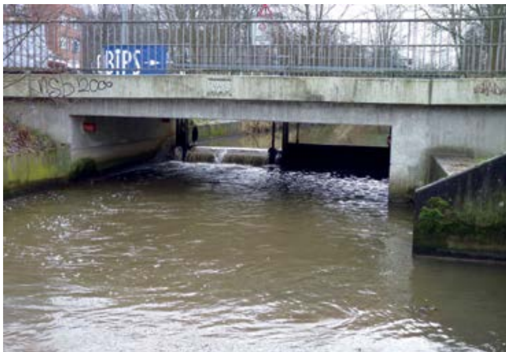
Abb. 44: Der Horner Stau in der Kleinen Wümme ist für viele aquatische Organismen nicht überwindbar. Langfristig ist eine Umgestaltung anzustreben (Gewässer 2. Priorität).
