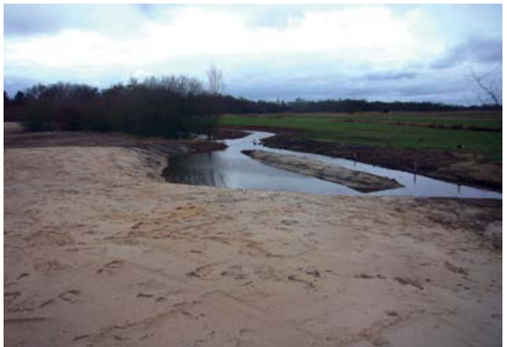
Abb.33: Bauphase der Renaturierung am Huchtinger Fleet im Bereich Hohenhorster Weg (umgesetzt 2012, Foto: planungsgruppe grün, Projektträger Bremischer Deichverband am linke Weserufer)
