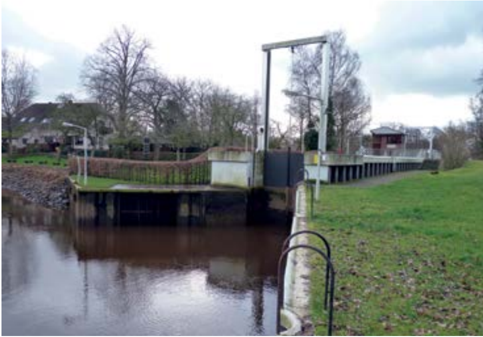
Abb. 45: Dammsiel an der Mündung der Kleinen Wümme in die Wümme. Ziel: Anpassung des Schleusenmanagements für eine Verbesserung der Durchgängigkeit für Fische. (Kleine Wümme ist ein Gewässer 2. Priorität).
