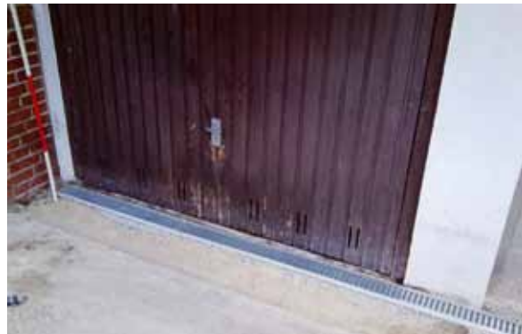
Frisch sanierte Einfahrt. Die tiefliegende Garage stand nach dem extremen Regen im August 2011 teilweise unter Wasser.
