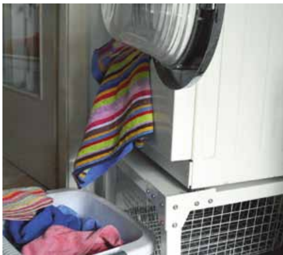
Waschmaschine auf Metallsockel.
