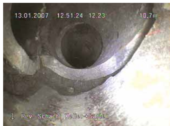
Schäden am Kanal durch Lagerversatz.
