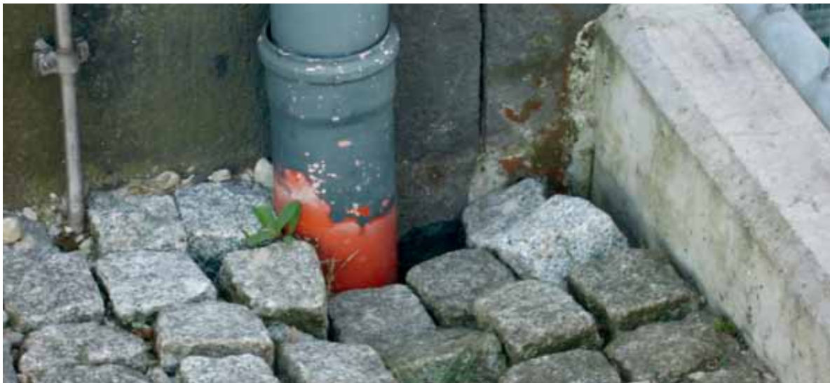
Absackung im Bereich eines Fallrohres.
