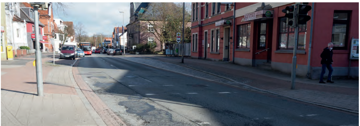
Abb. 18 Querung über die Landrat-Chr.-Str. zum Marktplatz mit technischen Oberflächenmängeln
