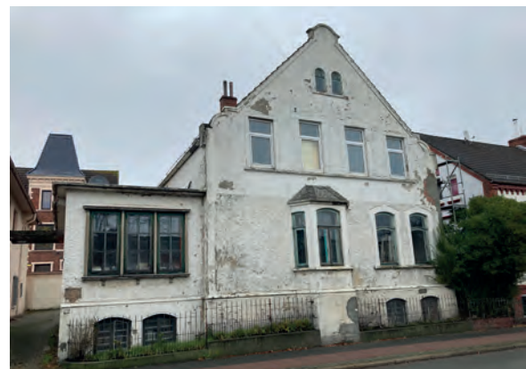
Abb. 28 Hoher Sanierungsbedarf bei historischen Gebäuden
