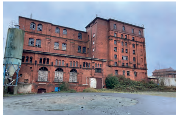
Abb. 27 Hoher Sanierungsbedarf Wollkämmerei
