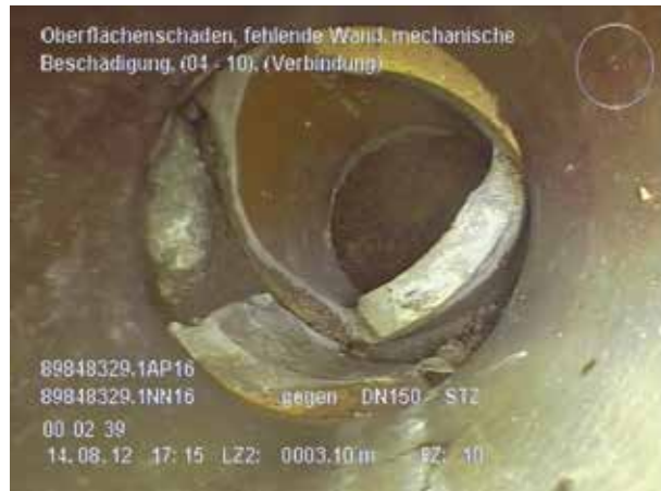
Defekte Leitung – Fehlende Wand
