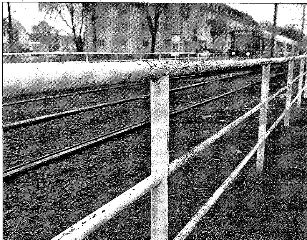
Die Speergitter im nördlichen Teil des Niedersachsendamms werden im Zuge der Sanierung des Ortsteils verschwinden. Foto: Schlie
