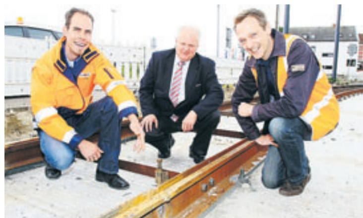
Heiko Schulze (links) und Henning Putensen (rechts) von der BSAG-Bauüberwachung überprüfen zusammen mit Oberverkehrsmeister Joachim Münch die neuen Gleise am Sielhof.
