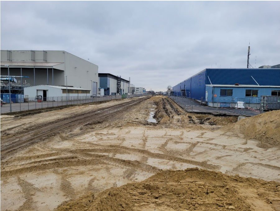
A 281 BA 2/2: Trassenvorbereitung im Bereich AIRBUS / Metro nach der Herstellung der Kampfmittelfreiheit
